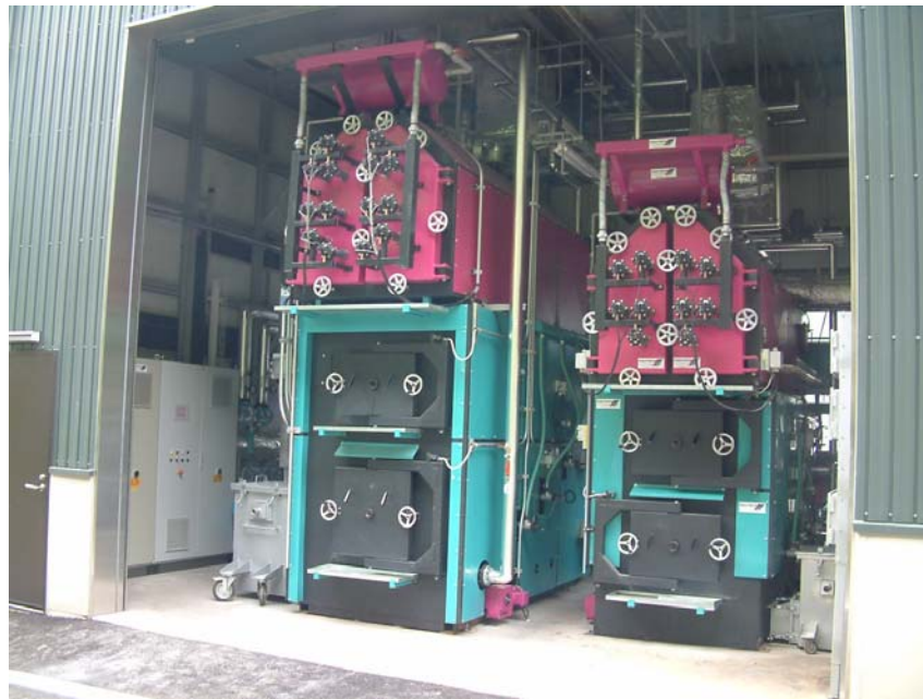
チップボイラー (500kw+250kw)
